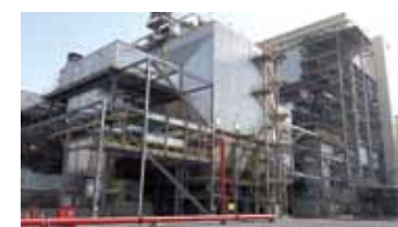
▲ 보일러 빌딩 및 집진 설비
